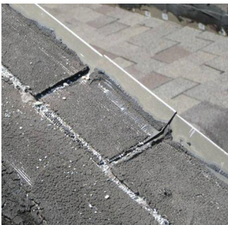
❑ Metal edge needing repair
